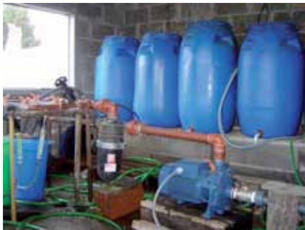
Figura 17. Sala de distribución de fertirriego con tanques de soluciones madre, bomba, filtros y los dos venturis en el vivero del Paider forestal, UNPSJB, Esquel, Chubut (Foto Enricci 2006).
