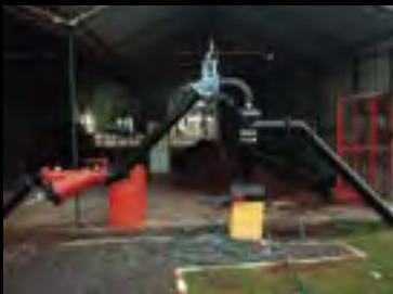
Fotografía 11. Mantenimiento del hidrociclón, válvula de alivio y turboclean.
