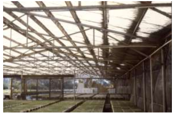
Figura 3.3.24 Algunos tipos de cubiertas de invernadero necesitan ser periódicamente limpiadas o reemplazadas. Esta vieja cubierta de fibra de vidrio se ha tornado amarilla y está cubierta con detritos de una cortina rompe vientos adyacente.
