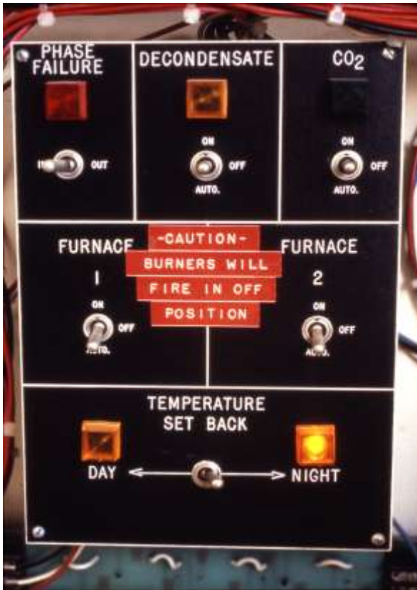
Figura 3.2.16 Algunos sistemas de control de invernadero incluyen un panel de control de descondensado, que abre ventilas y enciende el sistema de calentamiento y apaga los ventiladores durante un breve período, para reducir la humedad en el invernadero.
